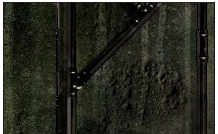
P13 - Le décor se réveille. La peinture sur les murs bulle. (ref Clousot) Les parois suintent, de l'eau se met à couler.
